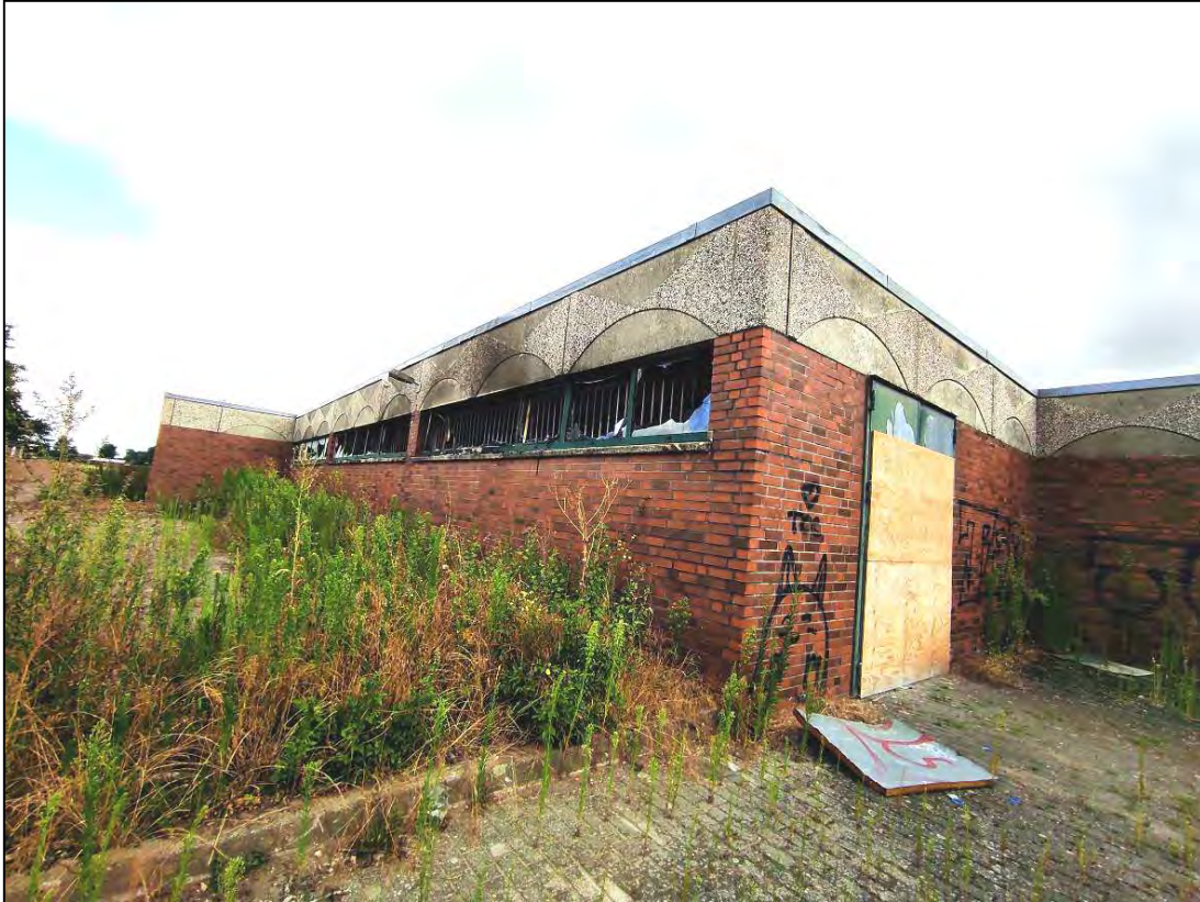
Bild 2: Eingeschlagene Fenster und Brandspuren (eigene Aufnahme, 27.07.2022)
