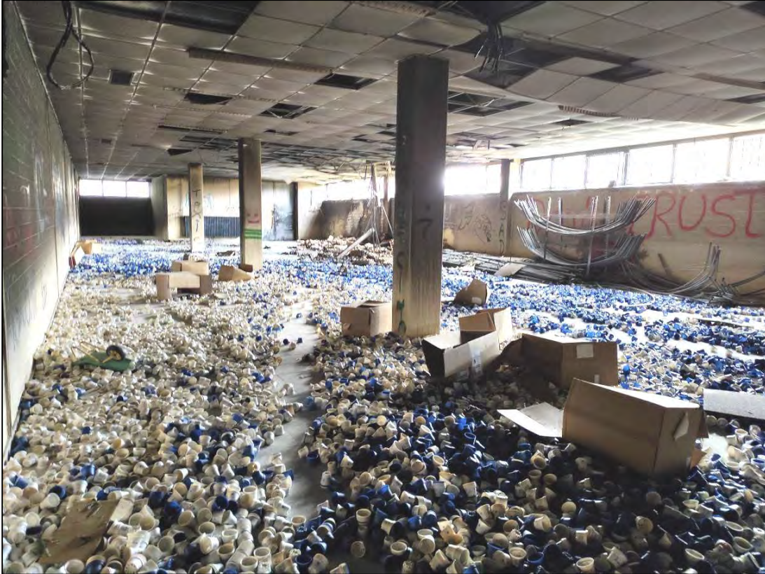
Bild 4: Von Vandalismus geprägter Innenraum, verstreute Pflanztöpfe, welche hier in Kartons gelagert wurden (eigene Aufnahme, 27.07.2022)
