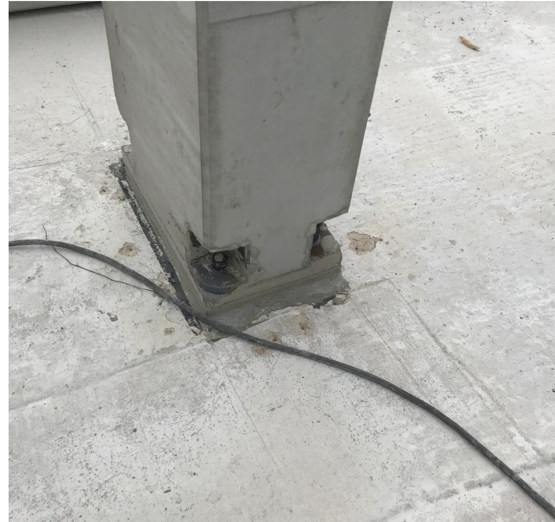
[5] Fertigteilstütze mit Schraubverbindung (Kreis Viersen)
