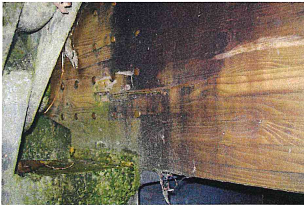
HOLZ BEI LINKER EINLEITUNG DES VORDEREN STAHLQUERTRÄGERS GERISSEN
