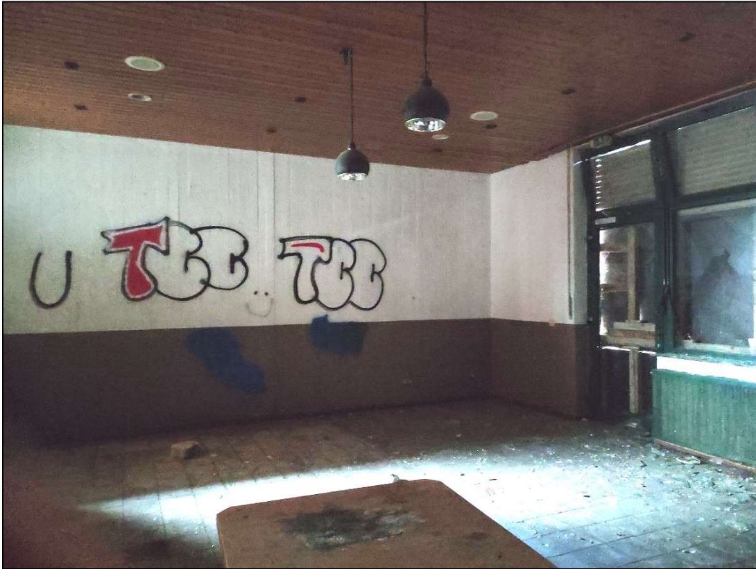
Bild 6: Von Vandalismus geprägter Innenraum mit eingeschlagenen Scheiben (eigene Aufnahme, 27.07.2022)
