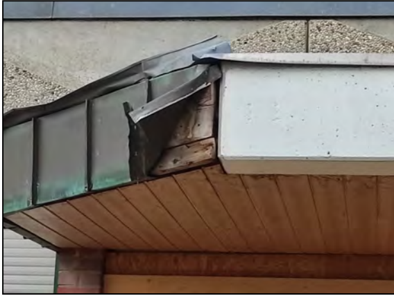
Bild 11: Beschädigte Dachverkleidung, Beispiel für potenzielles Versteck für Fledermäuse (eigene Aufnahme, 27.07.2022)
