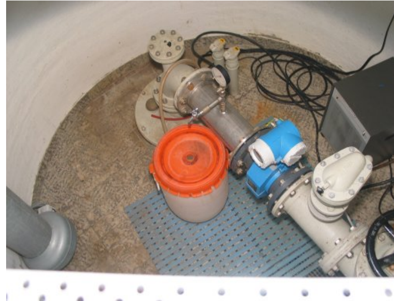
Brunnenstube des Tiefbrunnens „6“ (200 m tief)
